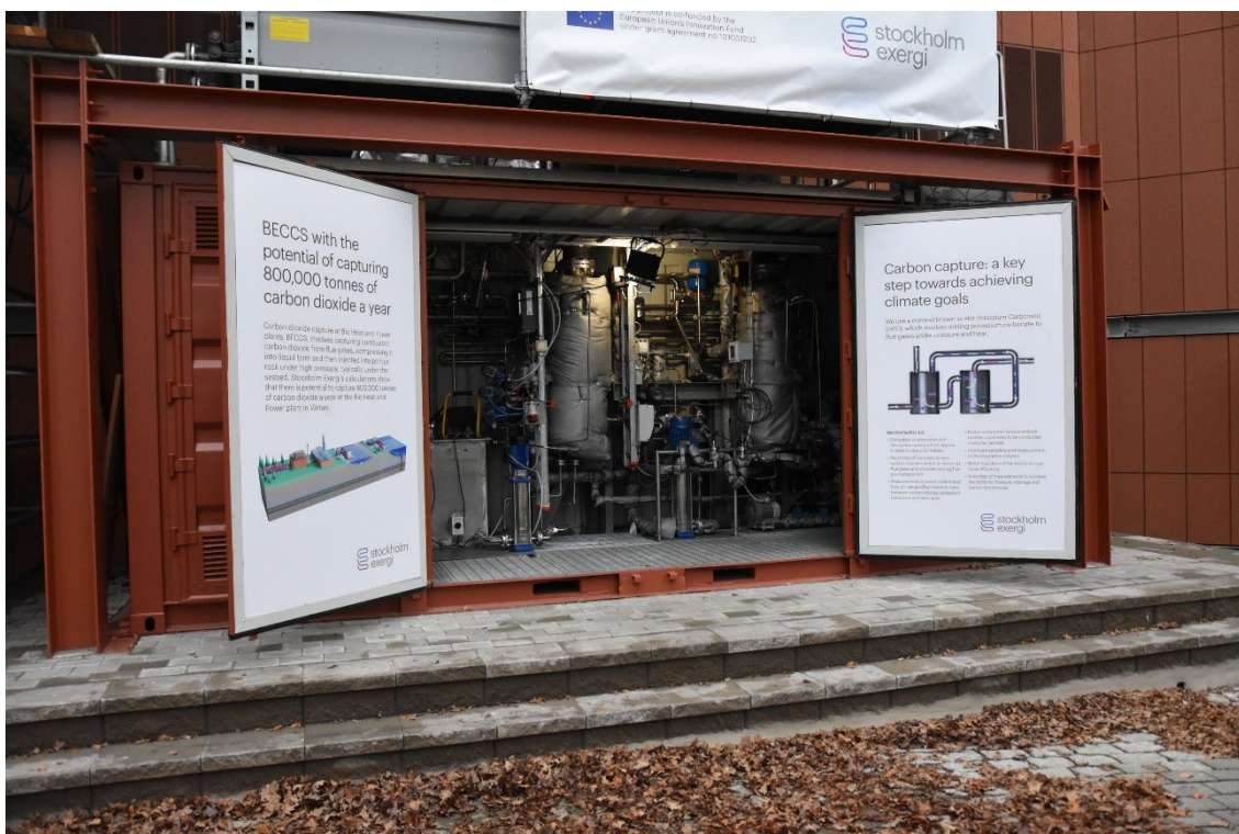
Figur 23. I figuren ses försöksanläggningen baserad på HPC-tekniken. Foto från försöksanläggningen. Processen inryms i en container med absorber och desorber som går upp genom taket. Rökgaser hämtas från KVV8:s befintliga skorsten. (Stockholm Exergi).
