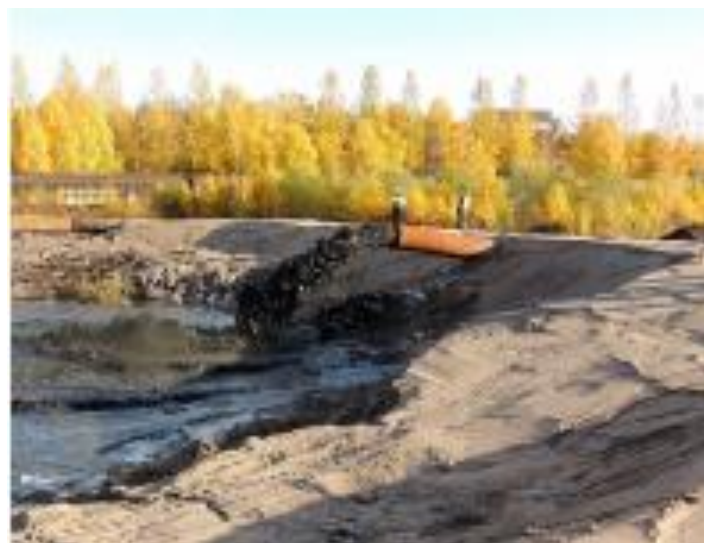
Bild 4.12b. Inpumpning av sugmuddrade massor, bild från "Slutrapport- Muddring av farled och hamn i Karlsborg"
