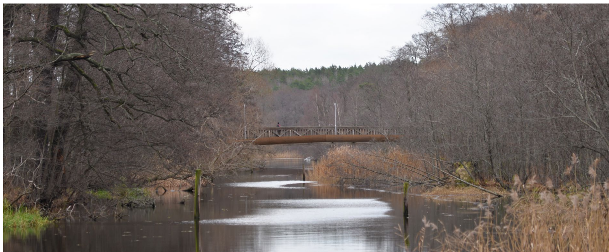
Fjärrvärmeledningen byggs i en rörbåge över Sickla kanal bredvid befintlig gång- och cykelbro.
