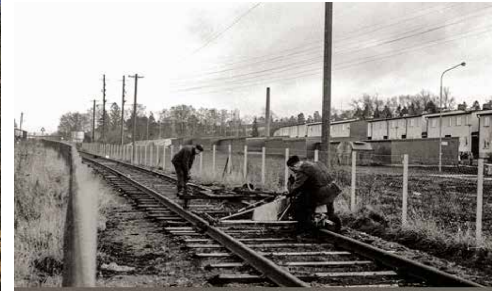
Foto från när järnvägen till Lövsta soptipp nedmonteras. I ett klipp från Dagens Nyheter i januari 1971, till en liknande bild, lyder bildtexten "Lövstabanen försvinner och lämnar plats åt en 15 meter bred väg. I vår är hela banan borta, i sommar påbörjas vägarbetena. Utbyggnaden är nödvändig både för sopbilstrafiken och för den blivande bebyggelsen i norra Hässelby villastad. I Lövsta står fortfarande sopvagnar på spåret, men dom väntar bara på att skrotas." (hesselby.com)
