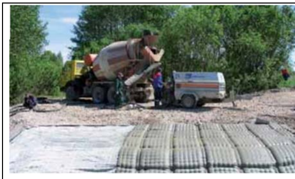
Figur 12.7. En betongmadrass kan jämföras med en luftmadrass med skillnaden att den fylls med betong. Paneler kan sys ihop till stora ytor i stora anpassade till önskad geometri. Madrassen läggs på fiberduk och förankras under installationskedet i bakomliggande fyllning. Dykare krävs för installation och kontroll av inpumpning av betong under vatten. (Ur Incomat Concrete-filled geotextile mattress.)
